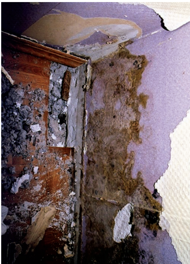
Bild 5: Schimmelpilzbefall nach einem Leitungswasserschaden.
