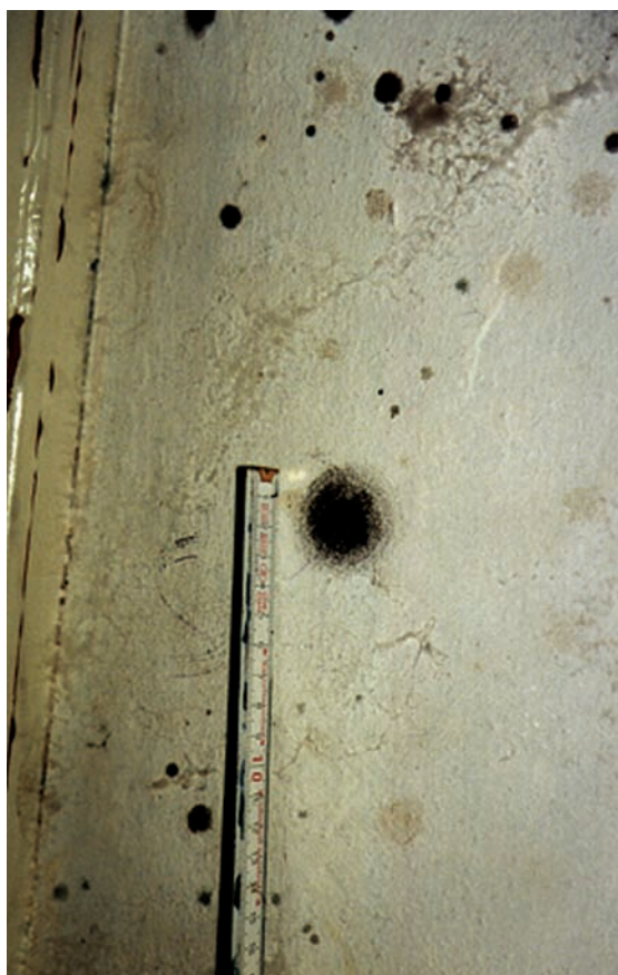
Bild 2: Kreisrunde Pilzkolonien an einer stark durchfeuchteten Wand.
