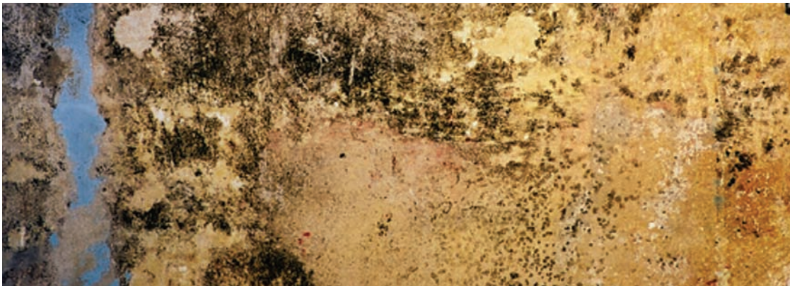
Bild 6: Großflächiger Befall nach Lösch- und Regenwassereinbruch.
